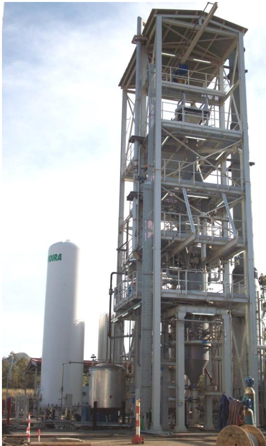
Impianto scala pilota
