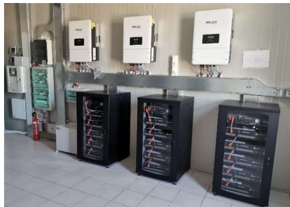
Figura 6: Inverter ibridi e sistema di accumulo elettrochimico.
