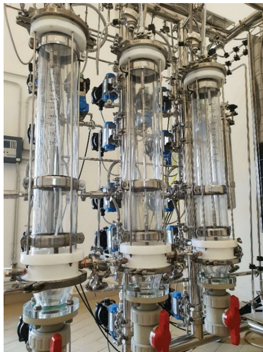
Figura 20: L'impianto pilota di upgrading del biogas
