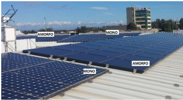
Figura 7: Campo fotovoltaico da 18,70kW
