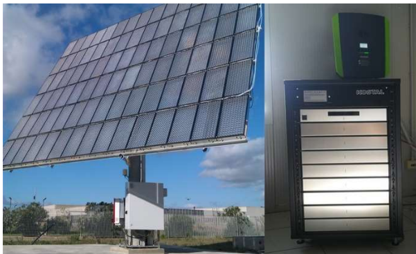
Figura 8: Impianto fotovoltaico a concentrazione (a sinistra) con inverter ibrido e relativo sistema di accumulo (a destra)
