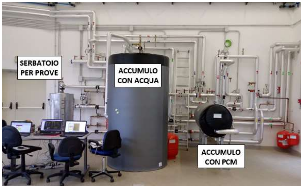
Figura 23: Impianto per la produzione, l'accumulo e l'impiego di energia termica.
