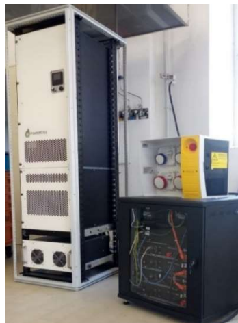
Figura 17: Generatore di potenza PEMFC con inverter e batterie al litio.
