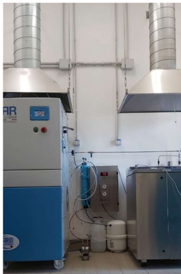
Figura 15: Generatori per la produzione di idrogeno da FER ( 1,05 \text{ m}^3/\text{h} , 13,8 barg).
